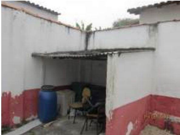
FIGURA 15 – ARMAZENAMENTO IRREGULAR DE RSS NO PSF-A (FONTE: ACERVO DO AUTOR, 2017)
